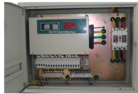
配电箱内视图
