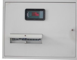
配电箱外视图
